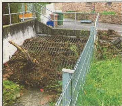
Verstopfte Rechen sorgen am Weihwiesenschbach immer wieder für Probleme. Foto: privat
