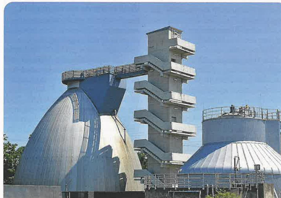
Im Faulturm entsteht Klärgas, was im Blockheizkraftwerk verstromt wird.
