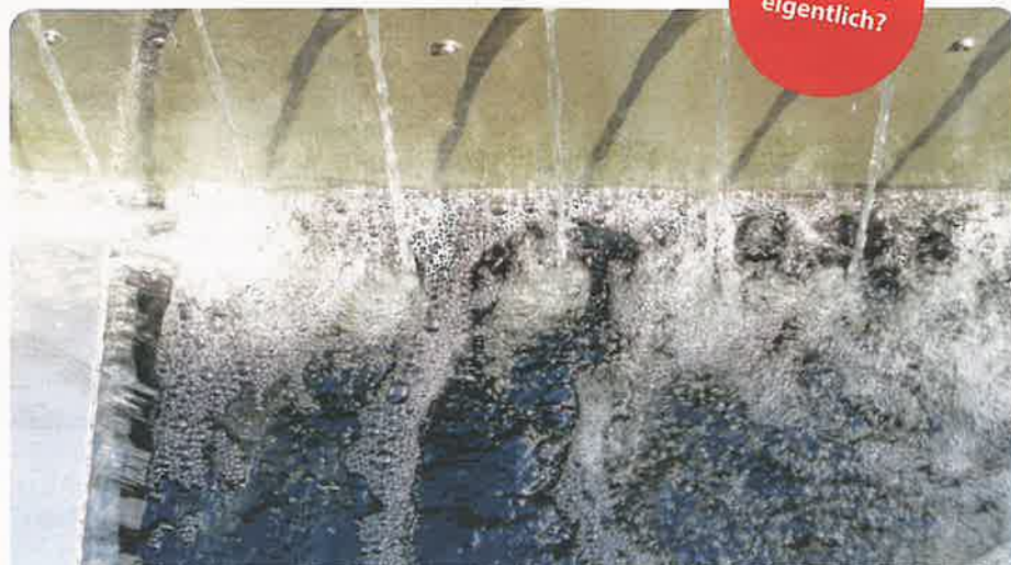
Gereinigtes Wasser fließt ins Nachklärbecken.
